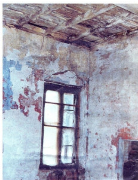
I soffitti in legno erano in condizioni di conservazione molto precarie.
