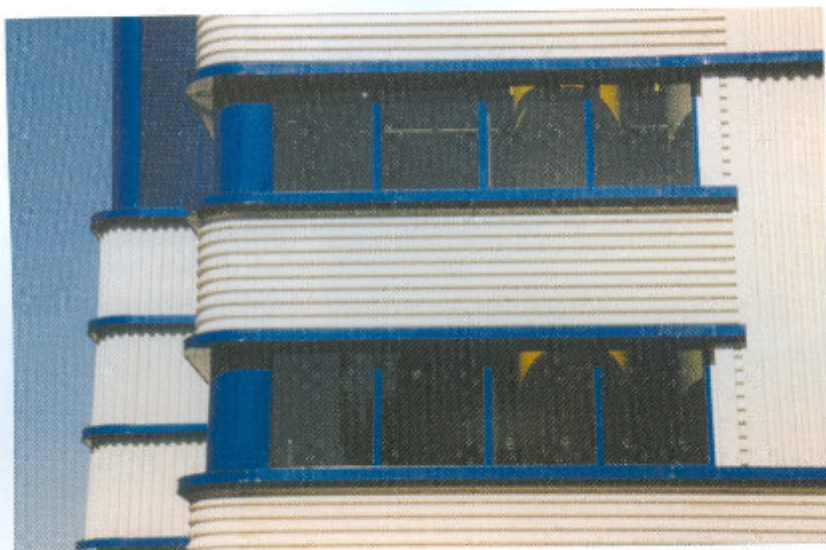
- In evidenza gli spigoli arrotondati del rivestimento e le differenti textures dei pannelli -
